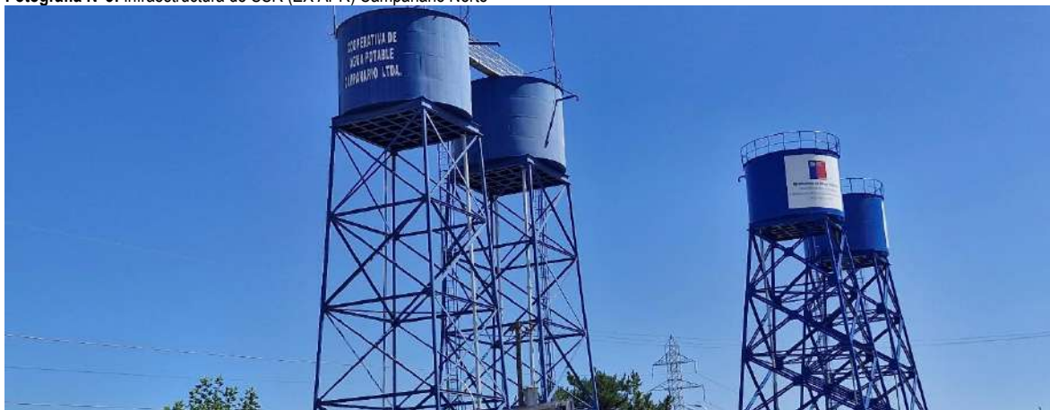
Fotografía N°3: Infraestructura de SSR (EX APR) Campanario Norte
